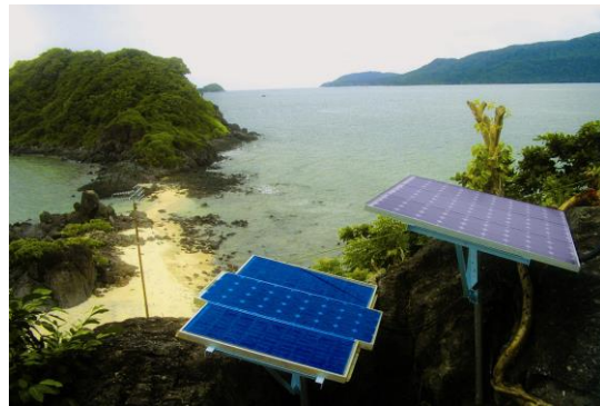
Hình 1. Trạm điện mặt trời thuộc dự án "Nâng cấp và phát triển hệ thống điện mặt trời Côn Đảo"
