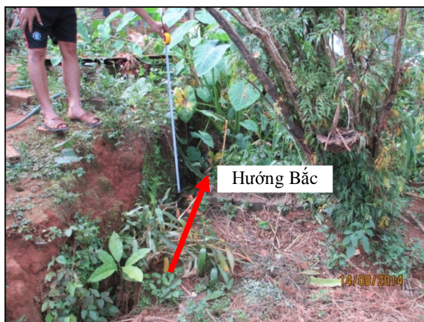
Hình 7. Vết nứt sụp trong căn nhà số 135/33/7A, rộng 30cm, sụp sâu 60cm
