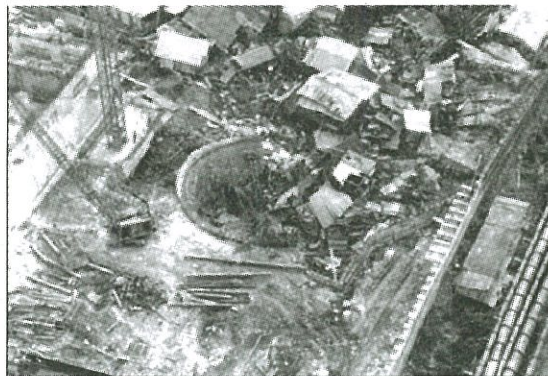
Hình 1: Trạm bơm Bangkok bị sập khi đào đất
