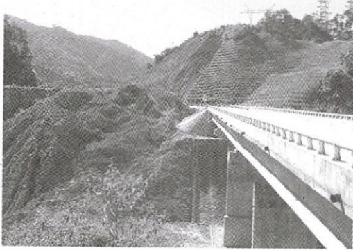
Hình 3a: cầu cạn cốt bê tông đoạn đường quanh co nguy hiểm
